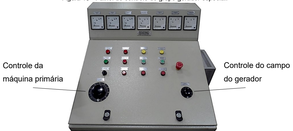
Figura 13 - Painel de controle do grupo gerador especial.
