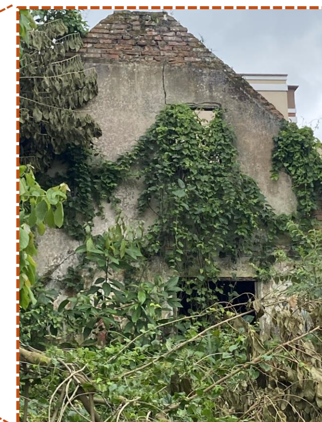
Figura 29: Anexo em colapso. Fonte: Autora (2024)
