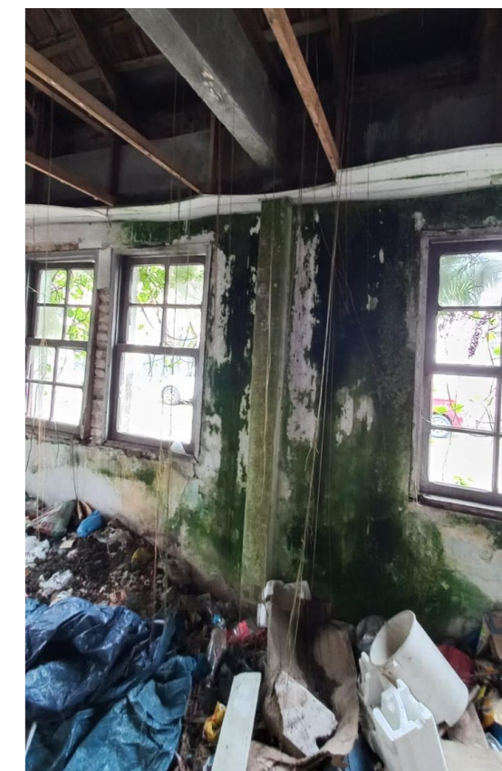
Figura 32: Infiltrações. Fonte: Autora (2024)
