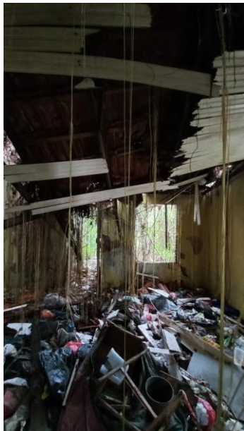
FOTO: cobertura em colapso.
