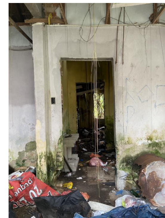
Figura 35: Piso coberto de lixo. Fonte: Autora (2024)
