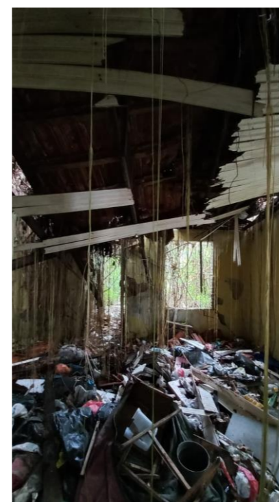
Figura 33: Forro destruído. Fonte: Autora (2024)
