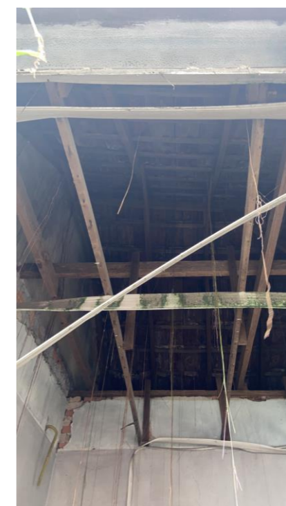
Figura 34: Queda do telhado. Fonte: Autora (2024)
