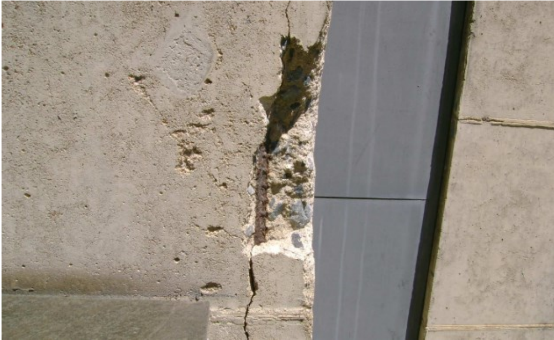
Figura 19 - Corrosão da armadura.
