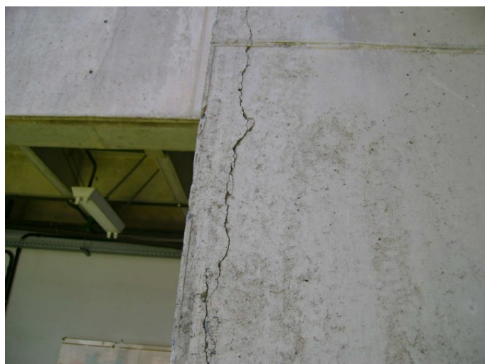
Figura 18 - Fissura vertical em pilar de concreto aparente
