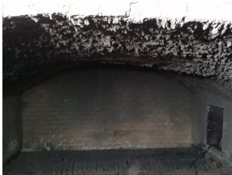
Figura 10 – Incrustação na parte inferior da parede da câmara reversa do aquecedor de fluido térmico BAFT
