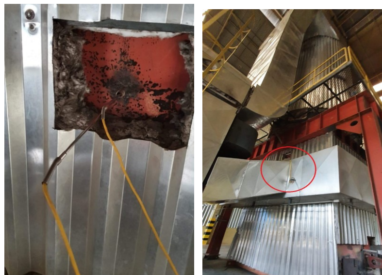
Figura 22 – Posicionamento dos termopares in loco no BAFT.
