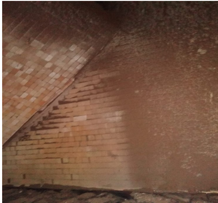
Figura 14 – Vista da parede lateral FTB ilustrando a progressão da incrustação em direção ao fim da grelha.
