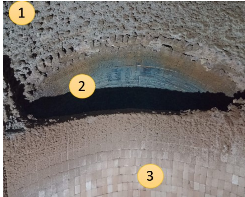
Figura 17 – Paredes internas do FTB com indicação de zonas degradadas
