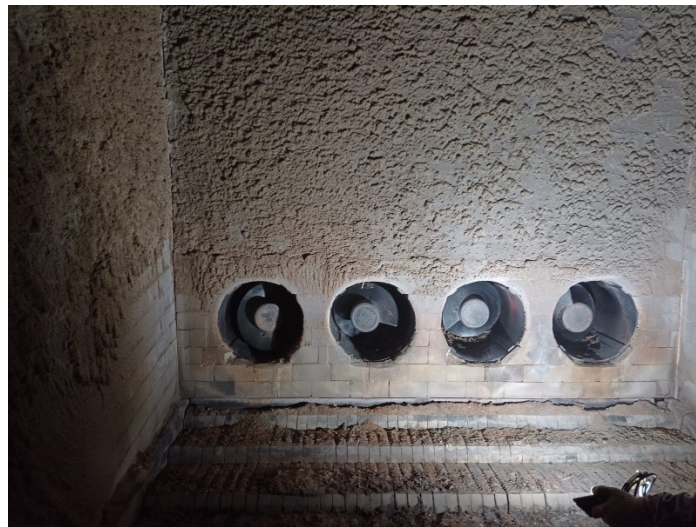
Figura 13 – Vista da parede das portas de alimentação FTB com a presença de incrustados
