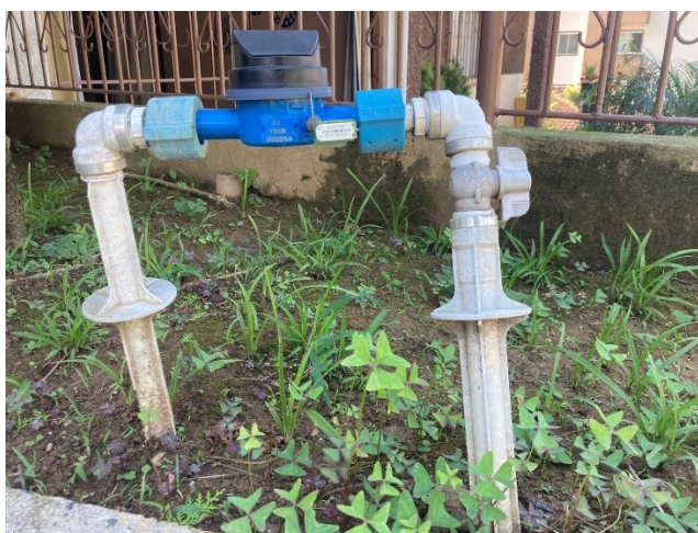
Figura 8 - Cavalete de Chão instalado em uma residência.
