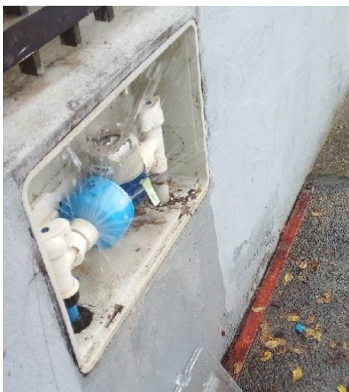
Figura 21 - Exemplo Típico de Vazamento na Rosca Macho do Retentor de Partículas no Modelo Novo.
