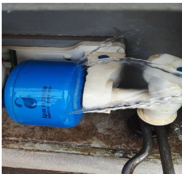
Figura 22 - Exemplo Típico de Vazamento em Peça Trincada do Retentor de Partículas do Modelo Antigo.
