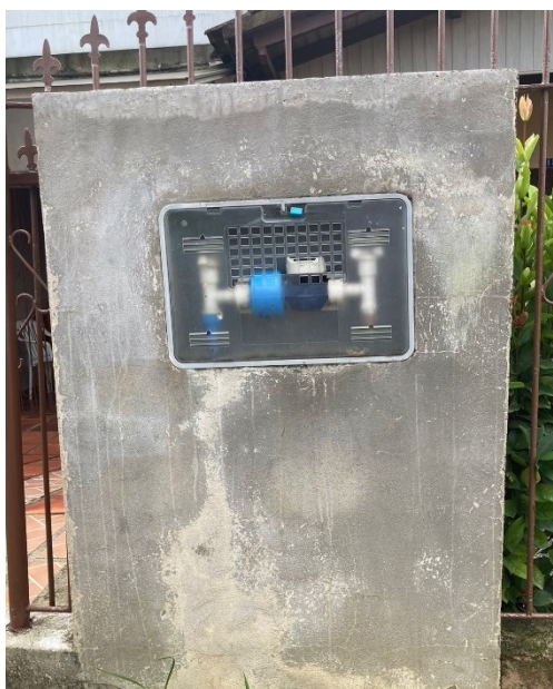
Figura 13 - Kit UMC e Caixa Padrão no muro de uma residência.
