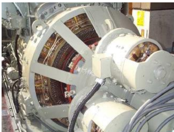
Figura 4: Gerador principal e excitatriz
