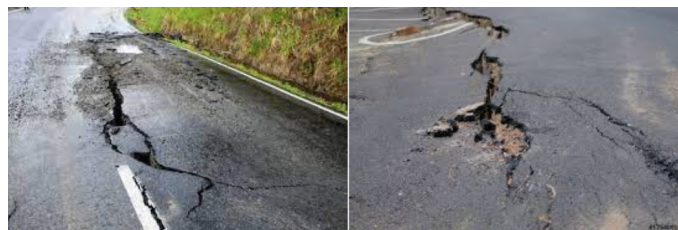
Figura 1 – Exemplos de rodovias danificadas
