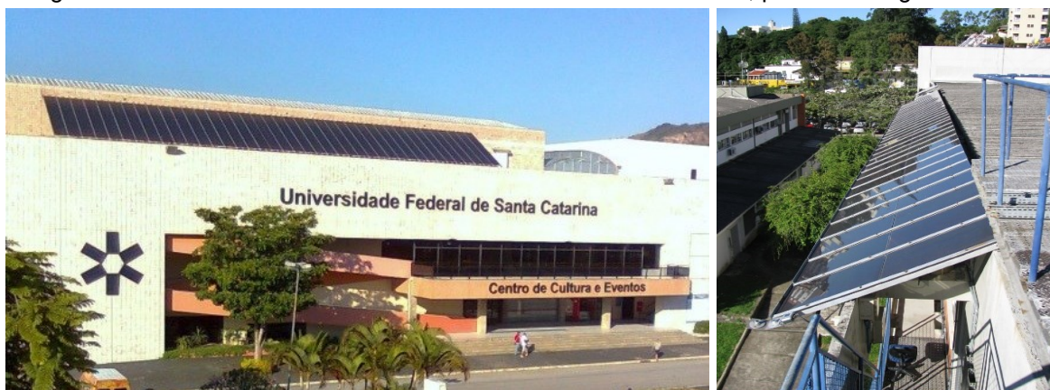
Figura 7 - Usinas Fotovoltaica UFSC - Centro de Cultura e Eventos, prédio da Eng. Mecânica.
