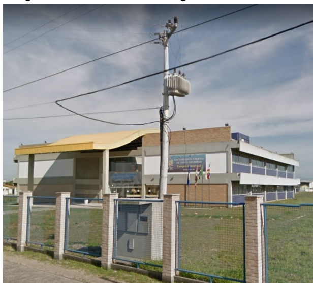
Figura 30 - Entrada de energia - ARA - Mato Alto.
