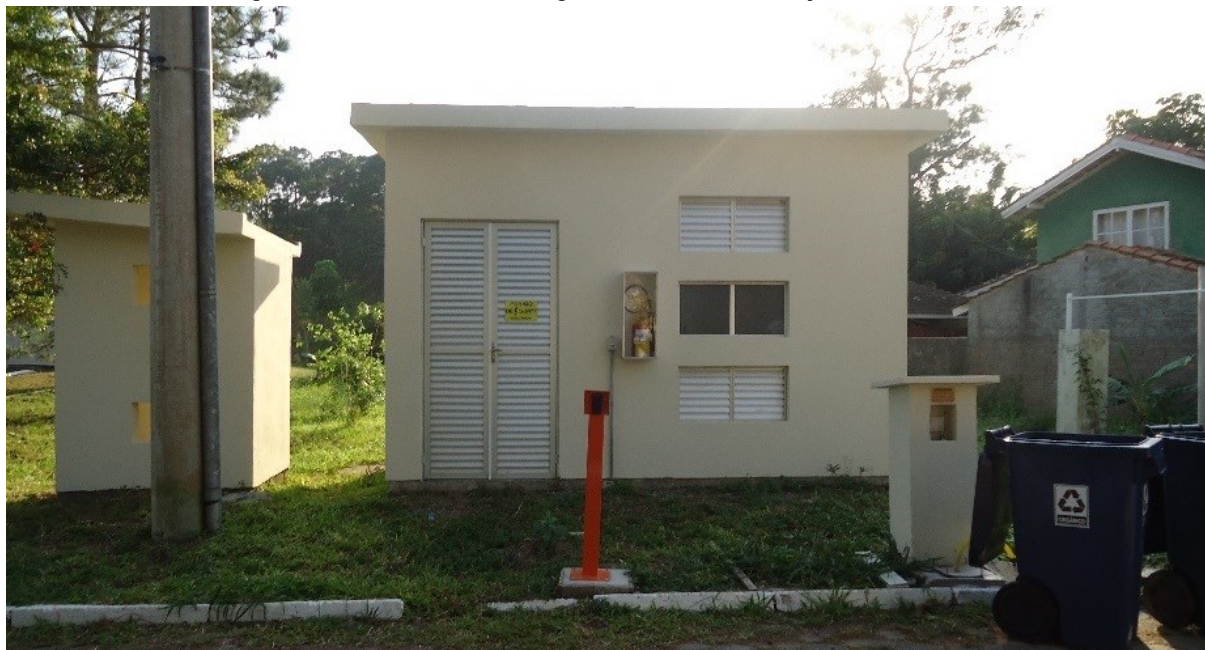
Figura 17 - Entrada de energia - FLN.BAR - Estação Maricultura.
