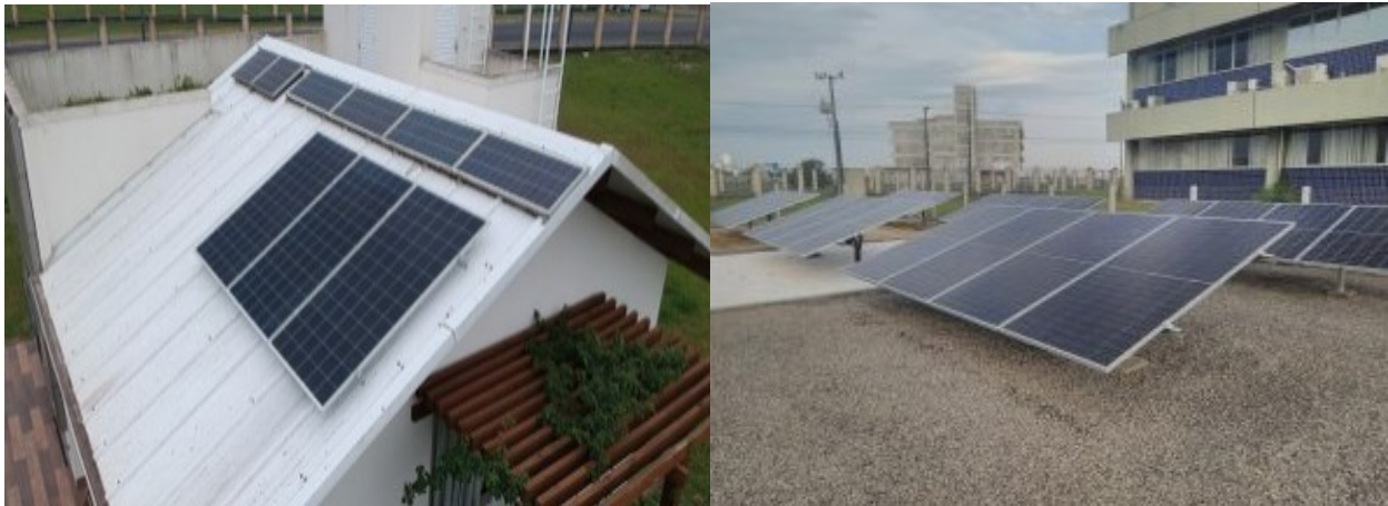
Figura 10 - Usinas Fotovoltaicas UFSC - Mato Alto (Subsistemas 1,2 e Planta solar I).
