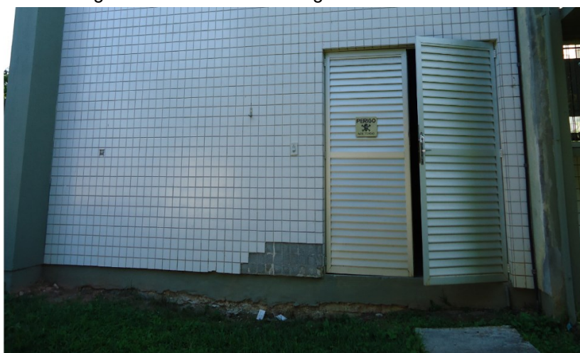
Figura 13 - Entrada de Energia - FLN.TRI - CMD02.
