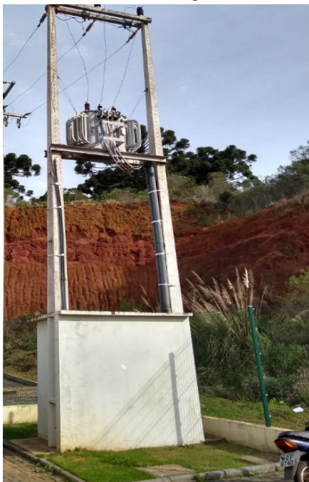
Figura 26 - Entrada de energia - CBS - CEDUP.
