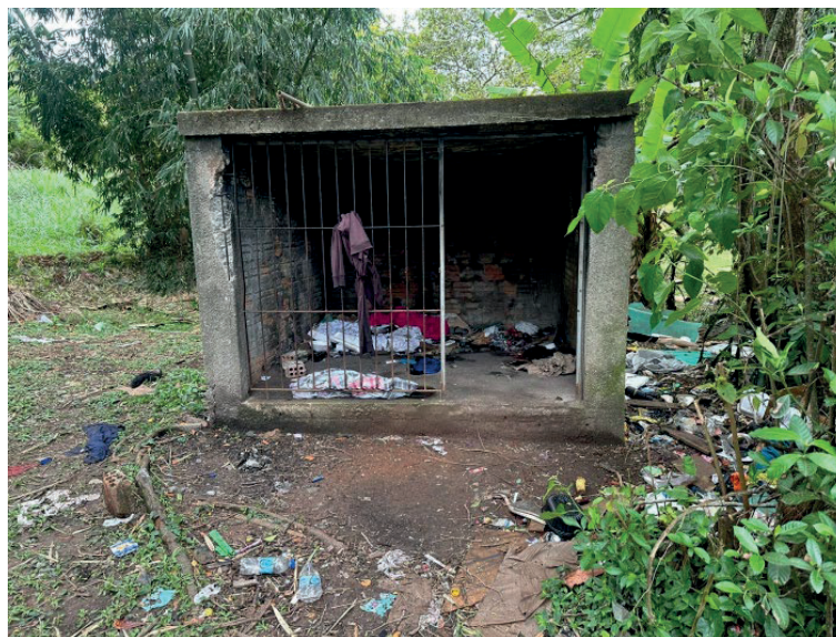
Figura 2 – Construção obsoleta utilizada como abrigo por usuários de drogas e moradores de rua
