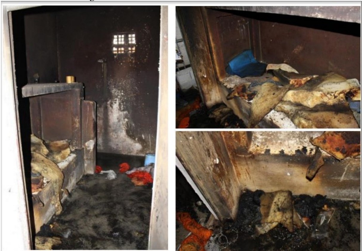
Figura 11 – Interior da cela nº 22 no dia do incêndio
