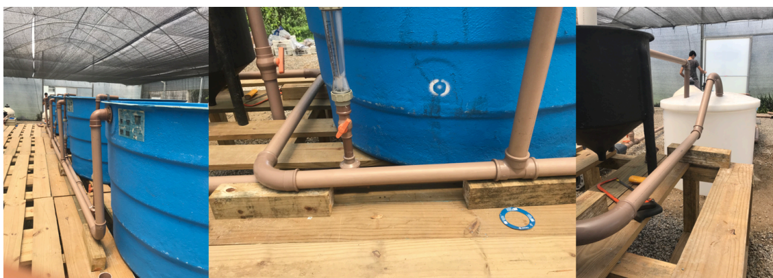
Figura 36. Detalhe saída lateral e entrada no filtro biológico
