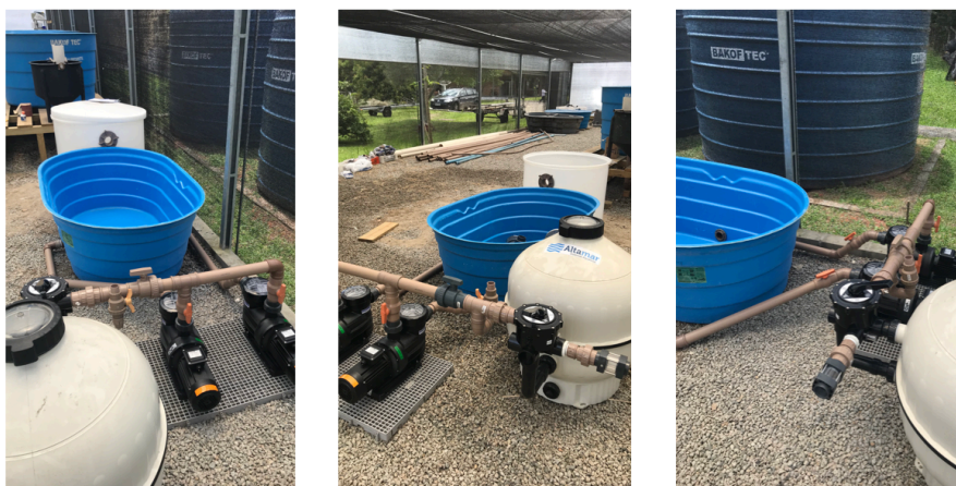
Figura 33. Posicionamento SUMP, motobombas e filtro BEAD
