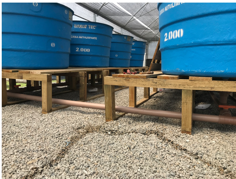
Figura 30. Tubulação de drenagem inferior
