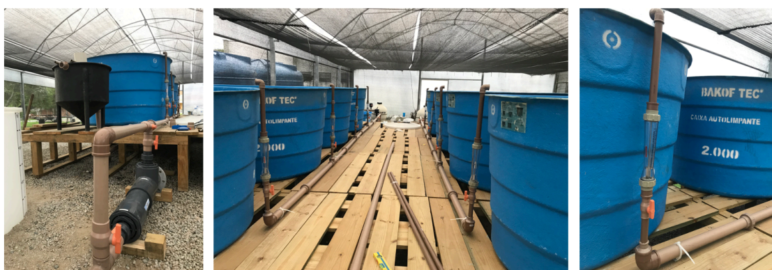
Figura 35. Detalhe abastecimento individual tanques
