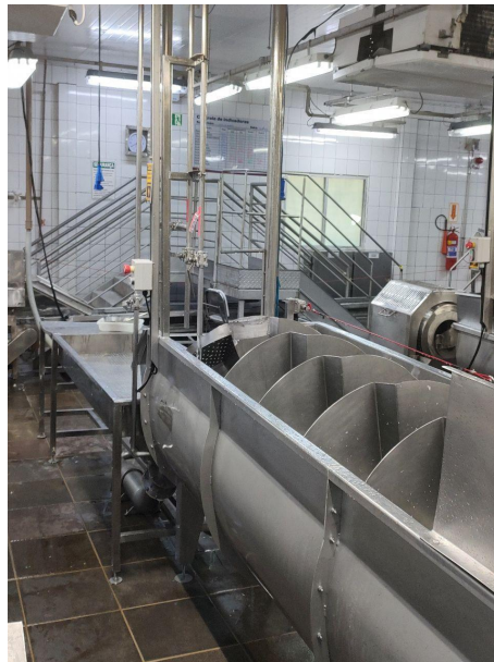
Figura 11 - Mini-chiller de miúdos
