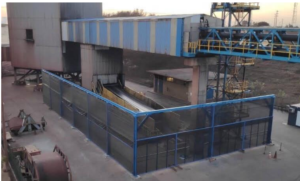
Figura 39: Telas de proteção para área operacional
