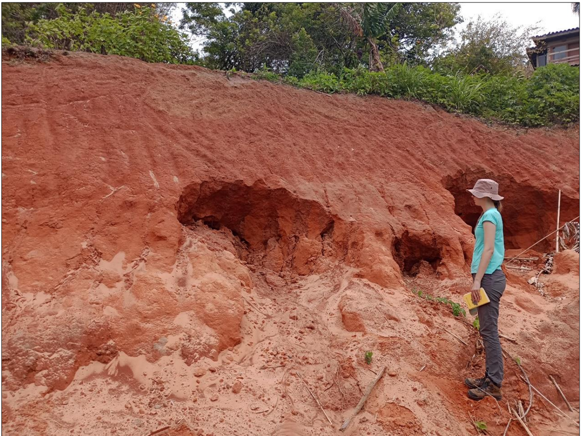
Figura 21. Corte de terreno onde é possível observar um perfil de solo típico da Unidade AQP sq em processo de colapso.
