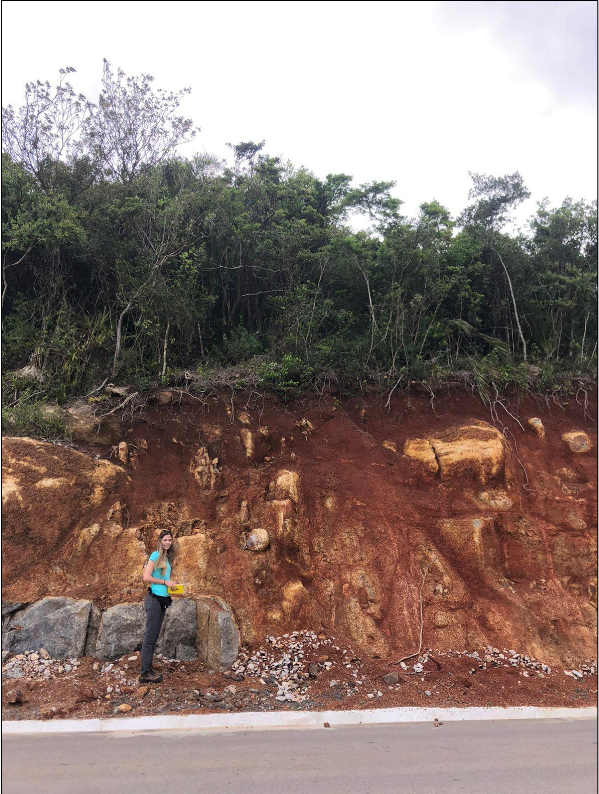
Figura 25. Depósito coluvionar com presença de muitos blocos e matacões sem nenhum tipo de contenção.
