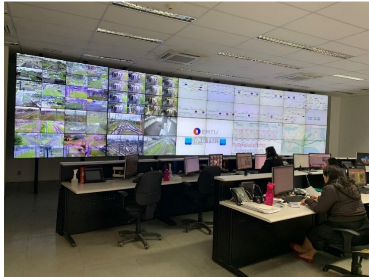
Figura 12: Centro de Controle Operacional
