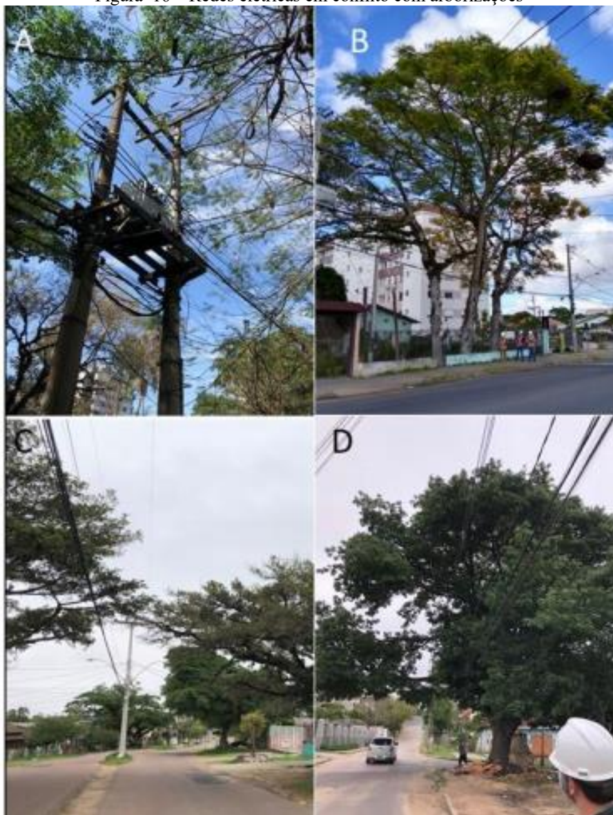
Figura 16 – Redes elétricas em conflito com arborizações
