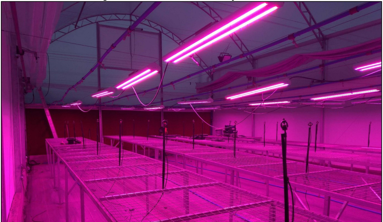
Figura 13 - Sistema de iluminação artificial.
