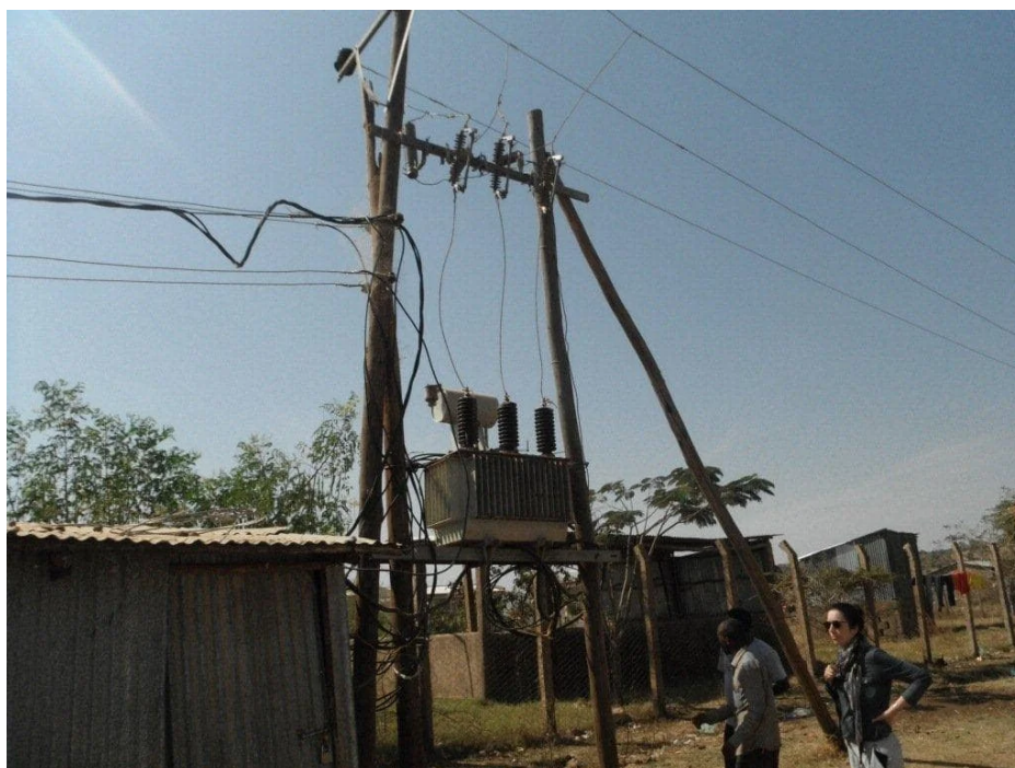
Figura 27: Transformadores em Adi Harush. Fonte: Alianza Shire (c2023)
