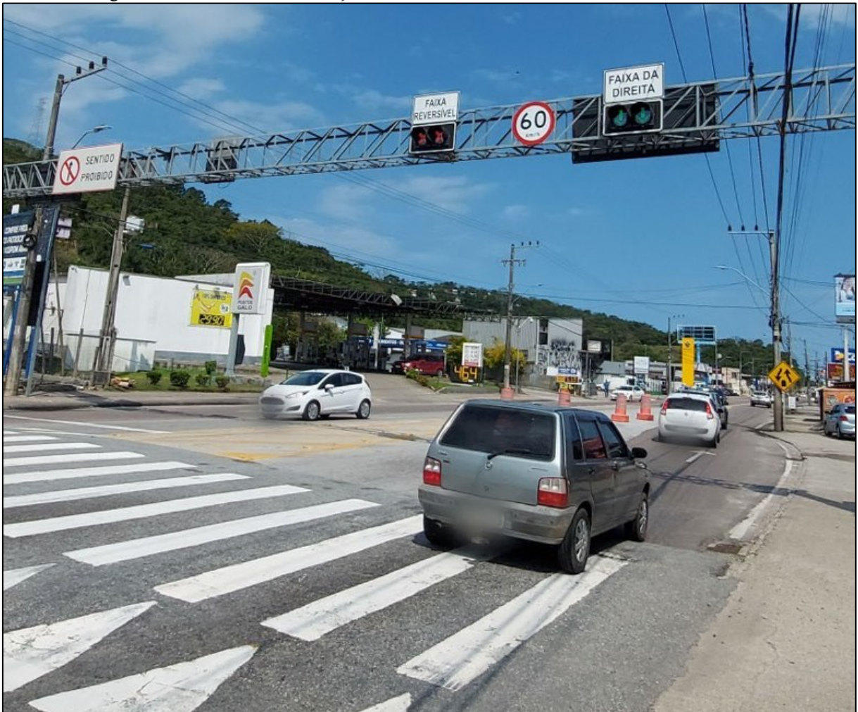
Figura 40 – Pórtico com sinalização semafórica e vertical na faixa reversível da SC-405.
