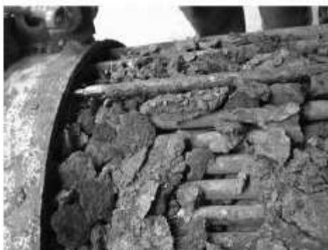
Figura 3 – Incrustação em trocadores de calor tipo casco e tubos.
