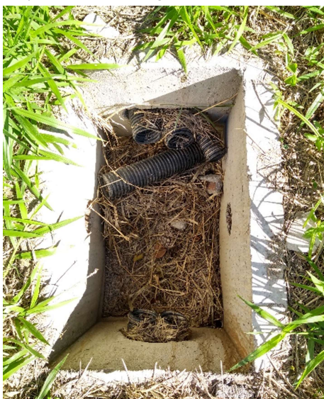
a) Caixa de passagem da rede elétrica
