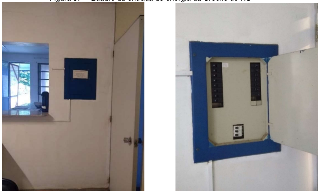
Figura 57 – Quadro da entrada de energia da Creche do HU
