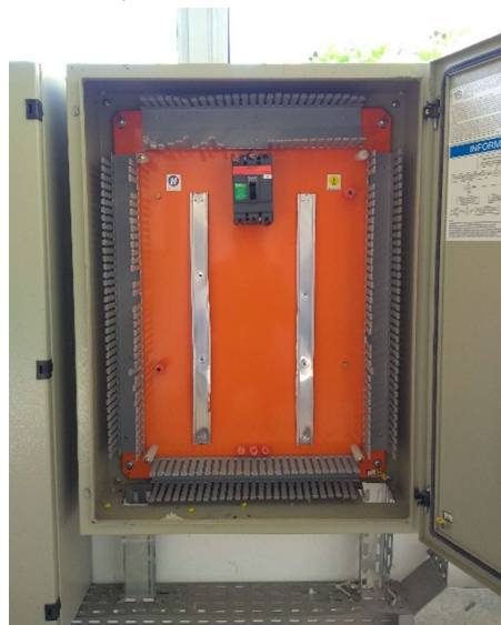
b) Quadro elétrico QF-INF
