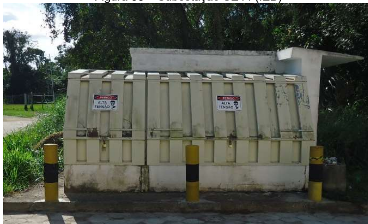
Figura 35 – Subestação SE44 (IEB)
