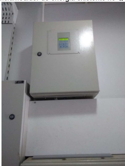
Figura 56 – Multimetro de energia existente no QGBT do IST01
