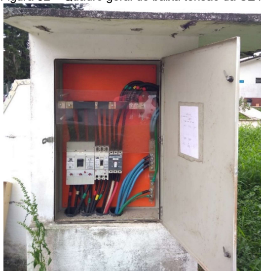
Figura 52 – Quadro geral de baixa tensão da SE44
