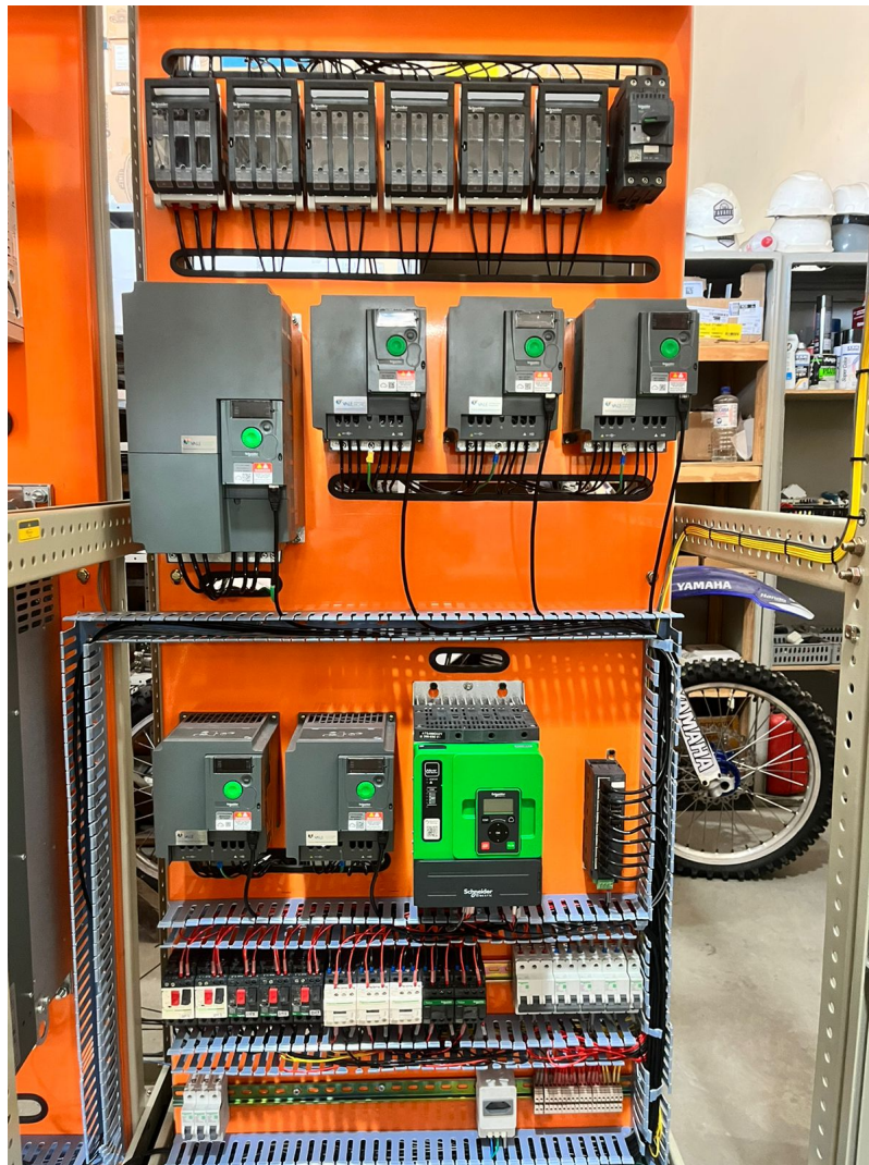
Figura 1 – Exemplo de painel elétrico aberto com vários equipamentos.
