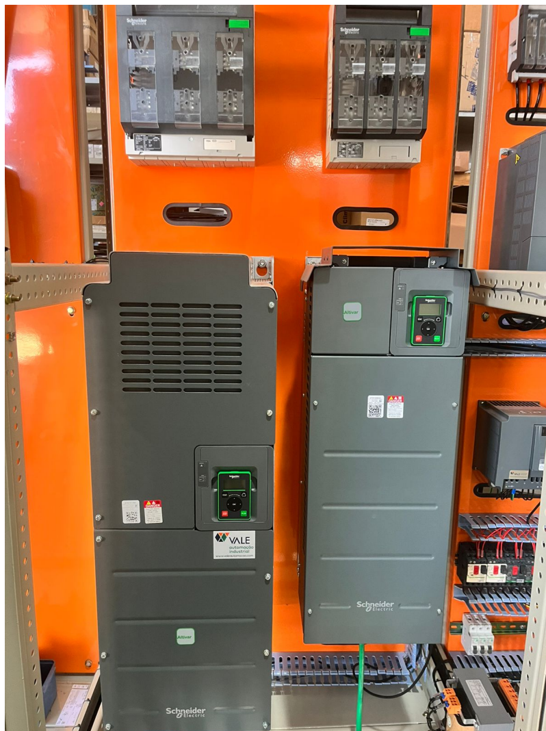
Figura 2 – Exemplo de painel elétrico aberto com inversores de frequência.
