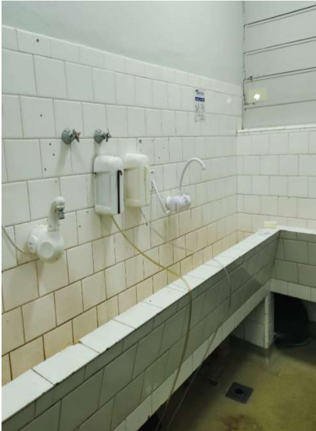
FIGURA 27 - Sala de Lavagem das Mãos da UFSM.
