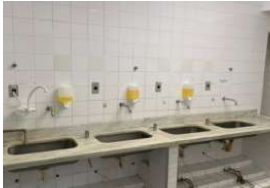
FIGURA 9 - Sala de para Lavagem das Mãos da UNESP.
