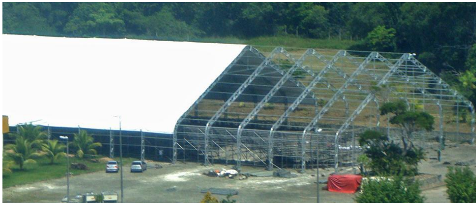
Figura 21 - Construção de galpão provisório tipo TFS com 50 metros de vão livre construído em estrutura modular boxtruss
