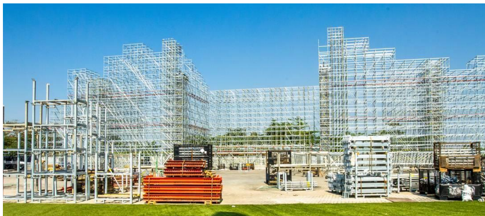
Figura 22 - Palco em estrutura tubular de ferro do festival Rock in Rio 2015
