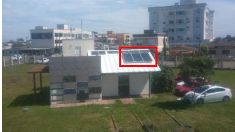
Figura 9. Sistema Fotovoltaico da Edificação Bioclimática.
