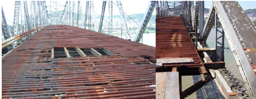
Figura 3 – Avançado estágio de corrosão do tabuleiro metálico da ponte Hercílio Luz.
