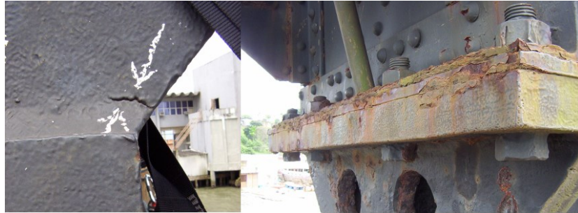
Figura 2 – Fissuras e alto estágio de corrosão na base dos pilões da ponte Hercílio Luz.
