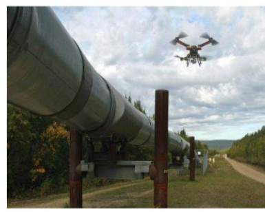
(d) Dutos de petróleo e gás
