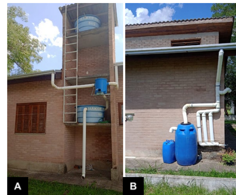
Figura 5: A) Detalhamento da captação de água pluvial armazenada no reservatório inferior. B) Armazenamento da água para uso externo. Fonte: elaborado pelos autores.
