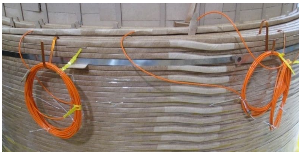
Figura 25 – Fibra óptica instalada ao longo do enrolamento
