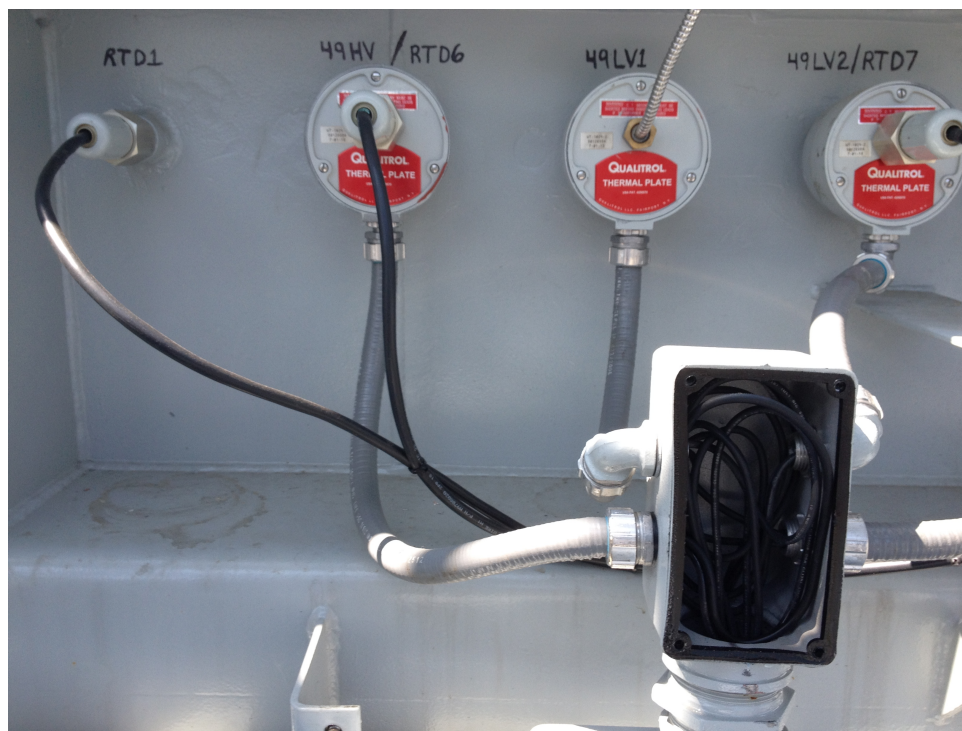
Figura 23 – Sensores PT100 instalados em transformador em operação.
