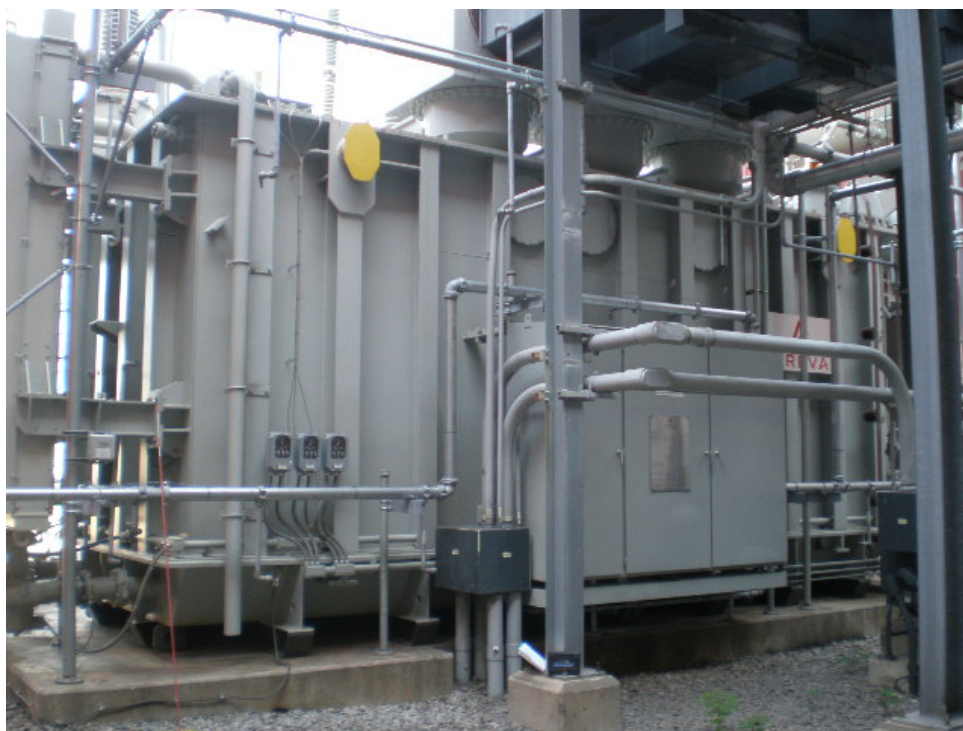
Figura 19 – Visores analógicos utilizados em transformadores em operação
