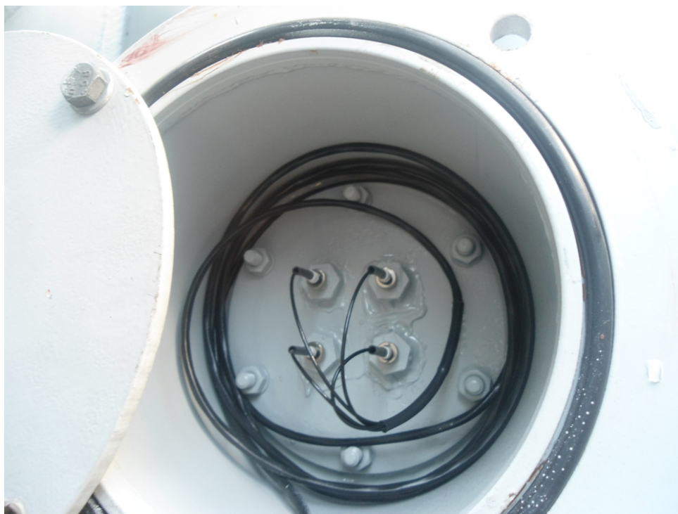
Figura 28 – Junction Box com fibra óptica em uso
