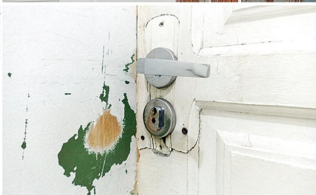
Estragos nas portas também evidenciam falta de manutenção e abandono da estrutura
