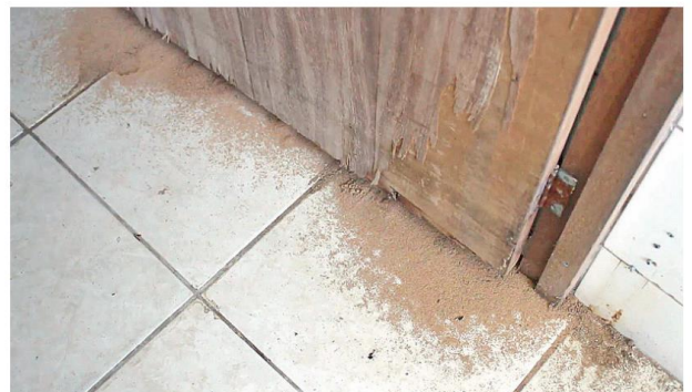
Portas e esquadrias de madeira consumidas por cupins também dominam ambientes
