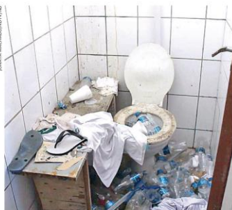
Antigo banheiro é utilizado como lixão
