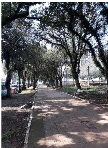
Figura 1: Passeio de pedestres em condições irregulares e sem piso podotátil, resultando em uma praça não acessível, conforme NBR 9050. Fonte: elaborado pelos autores.
