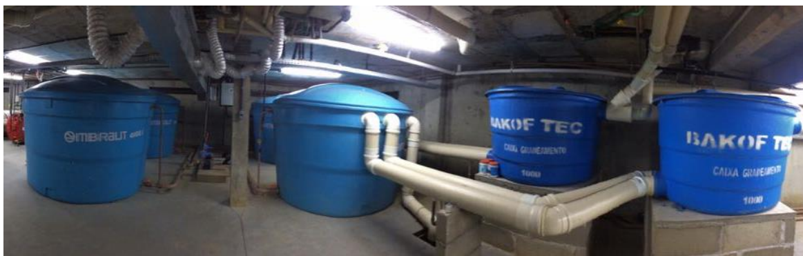
Figura 1: Cisternas para armazenamento da água coletada. Fonte: elaborado pelos autores (2018).
