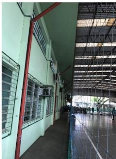
Figura 5: Coletores Verticais. Fonte: Autores, (2018).
