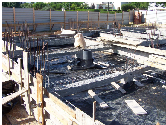
Figura 8: Isolamento Pleno. Fonte: AlmaVerde.
