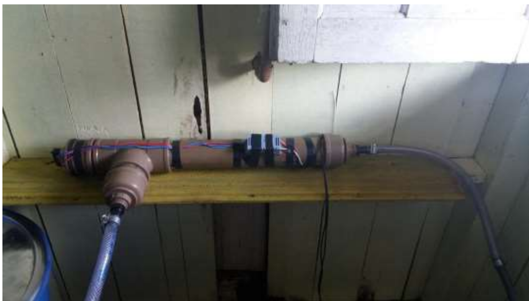
Figura 5: Filtro UV após a instalação. Elaborado pelos autores.
