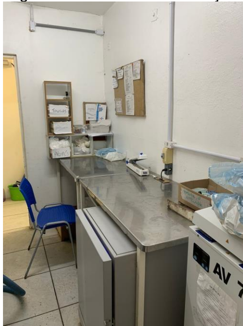
Figura 18 – Sala de esterilização.
