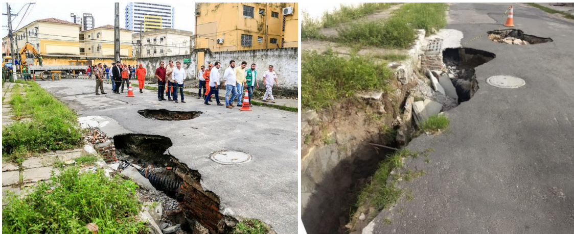
FIGURA 12 - RACHADURAS NAS VIAS, RESULTANTES DO PROCESSO DE SUBSIDÊNCIA DO SOLO
