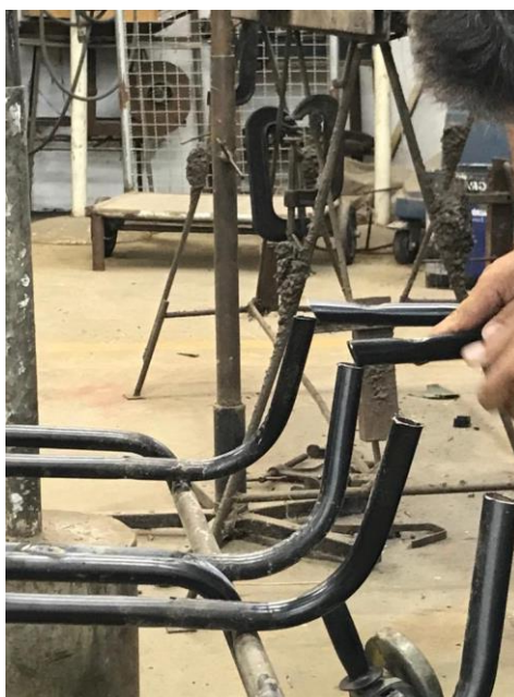
Figura 6: Estruturas das mesas e cadeiras desmontadas e em fase de recorte. Fonte: elaborado pelos autores.
