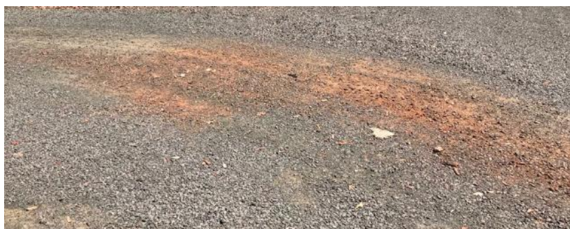
Figura 1: Patologias formadas no pavimento. Fonte: elaborado pelos autores.
