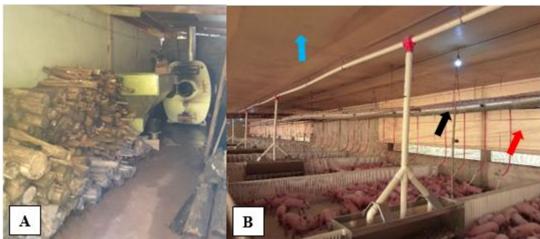
Figura 10 – Fornalha externa com sistema automático alimentada por lenha e pélete. A: fornalha externa com capacidade de aquecer através do fornecimento de lenha ou através do sistema automático com pélete. B: demonstração da tubulação interna de aquecimento da granja (seta preta), cortinado duplo (seta vermelha) e forro no teto (seta azul).
