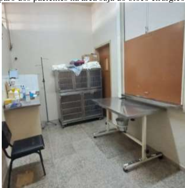
Figura 14 – Sala de preparo dos pacientes na área suja do bloco cirúrgico 5 do HVU-UFSM
