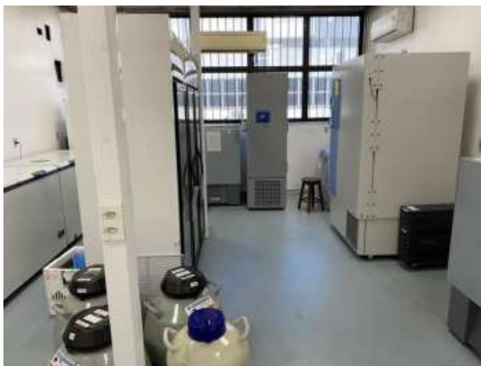
Figura 13. Sala de equipamentos do Setor de Virologia.
