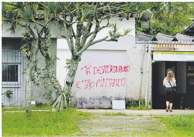
Pichação em prédio da instituição debocha da situação de abandono das estruturas do local
