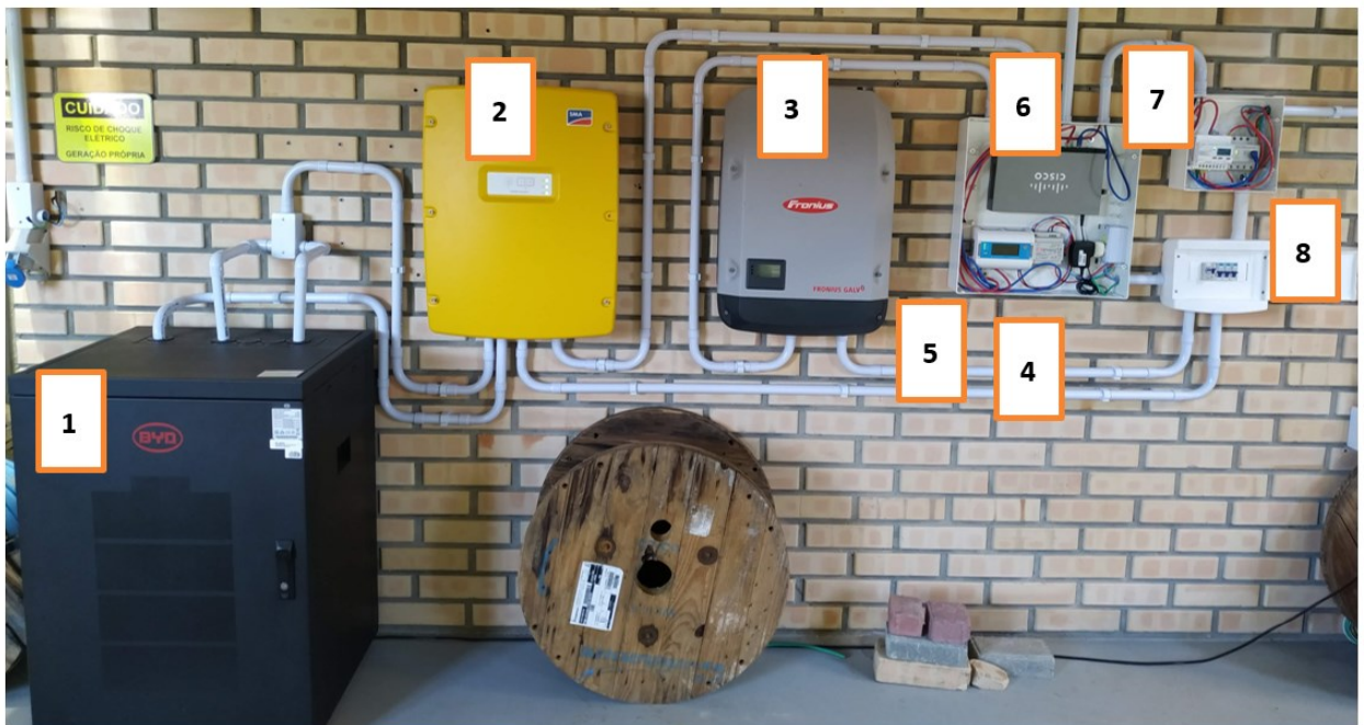
Figura 22 – Principais componentes do sistema de armazenamento de energia proposto.
