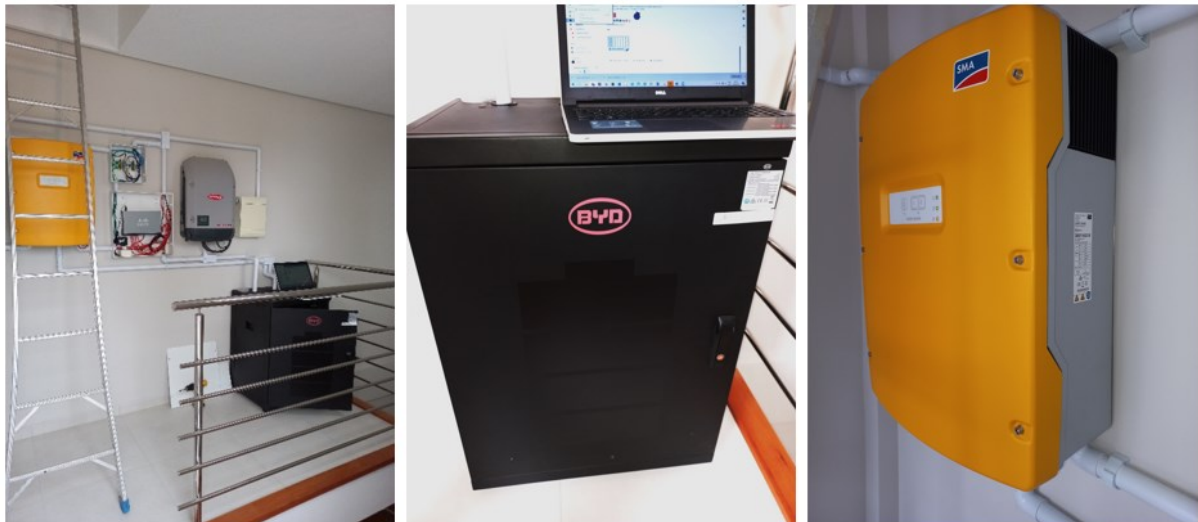
(a) Visão Geral do BESS
