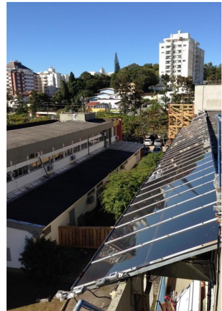
(b) Primeiro sistema FV interligado à rede elétrica do Brasil, instalado em setembro de 1997, localizado na UFSC.
