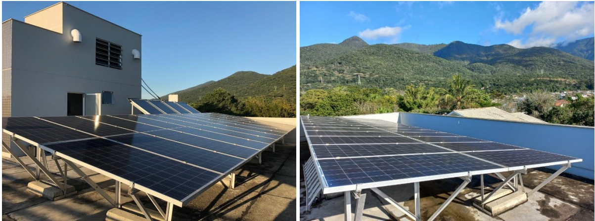
Figura 20 – Sistema fotovoltaico instalado na unidade prosumidora.
