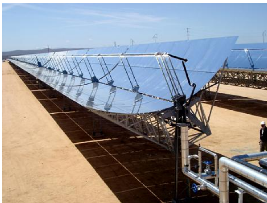
Figura 7 – Planta solar com coletores cilindro parabólicos.
