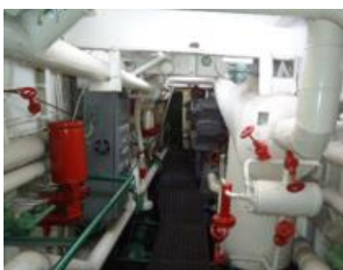
Figura 31 – Corredor de bombas da embarcação B.
