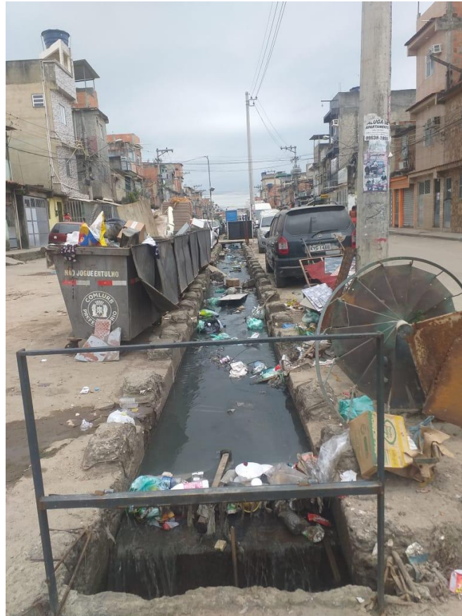
figura 16: uma vala por onde passam efluentes líquidos e com presença de resíduos sólidos
