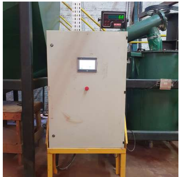
Figura 58 – Vista externa do painel elétrico
