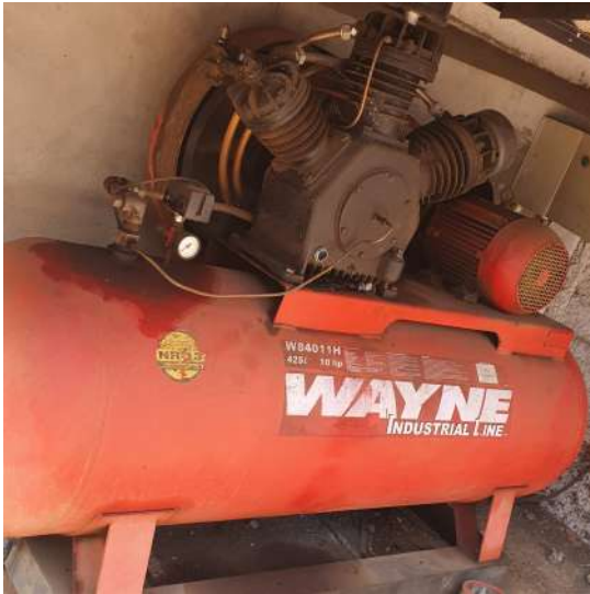
Figura 31 – Compressor de Ar da Empresa
