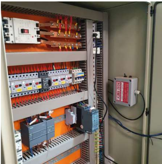
Figura 57 – Vista interna do painel elétrico
