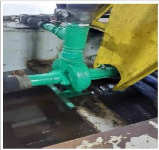
Foto 12 - Bomba centrífuga serviços gerais.
