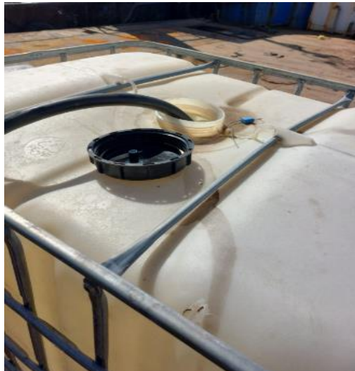
Figura 12 – Bombona com mangueira para transferência de diesel
