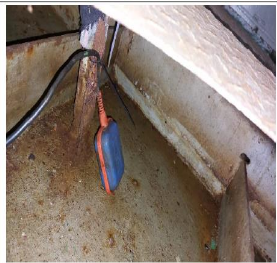
Foto 11 - Sensor para bomba de alagamento.
