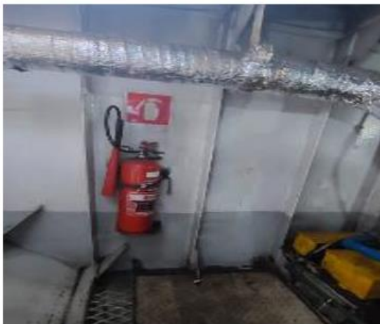
Foto 03 - Extintor CO2 - Praça de Máquinas.
