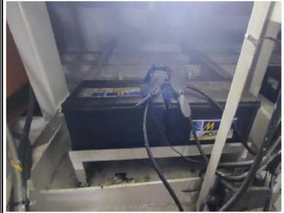
Foto 02 - Presença de baterias Chumbo/Ácido 180Ah.
