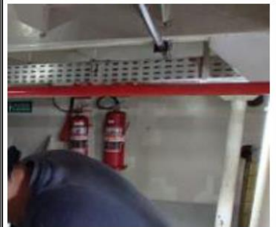
Foto 04 - Extintor CO2 e Pó Químico - Praça de Máquinas.
