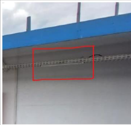
Foto 14 - Luminária de LED.
