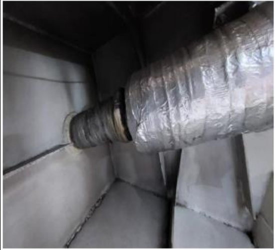
Foto 10 - Escape revestido em termotape e alumínio isolante.
