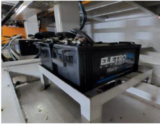
Foto 01 - Presença de baterias Chumbo/Ácido 180Ah.
