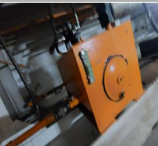
Foto 05 - Tanque hidráulico 60 litros.
