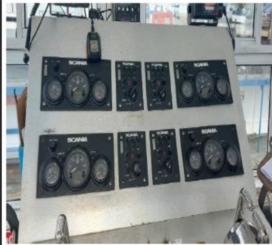
Foto 20 - Painéis de leitura e acionamento MCP.
