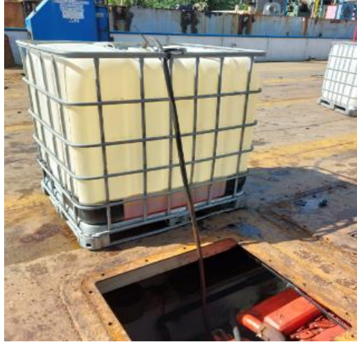
Figura 11 – Bombona para armazenamento diesel.
