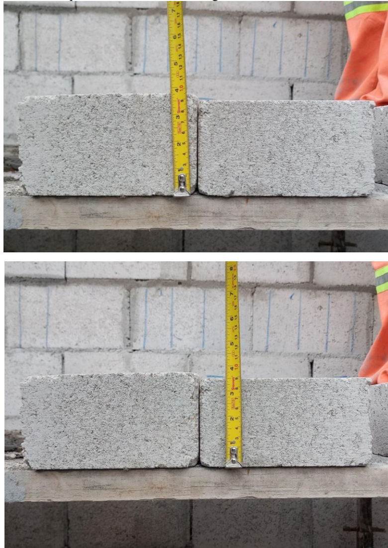
Figura 21 - Discrepâncias nas características geométricas entre canaletas de concreto
