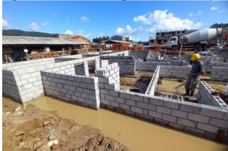
Figura 19 - Subsolo com nível de água da chuva acima das sapatas
