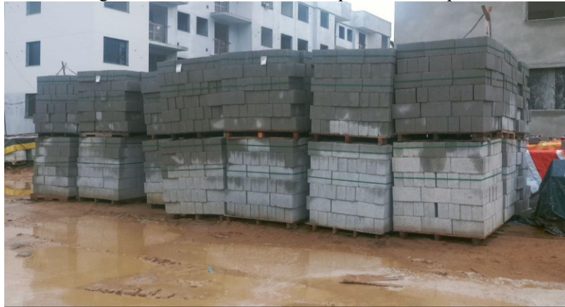
Figura 18 - Blocos de concreto expostos a intempéries
