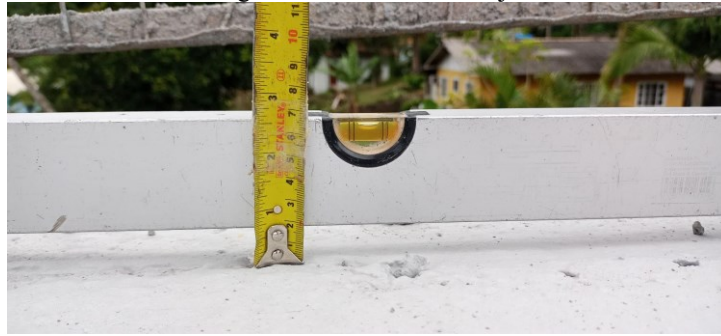
Figura 23 - Desnível em laje
