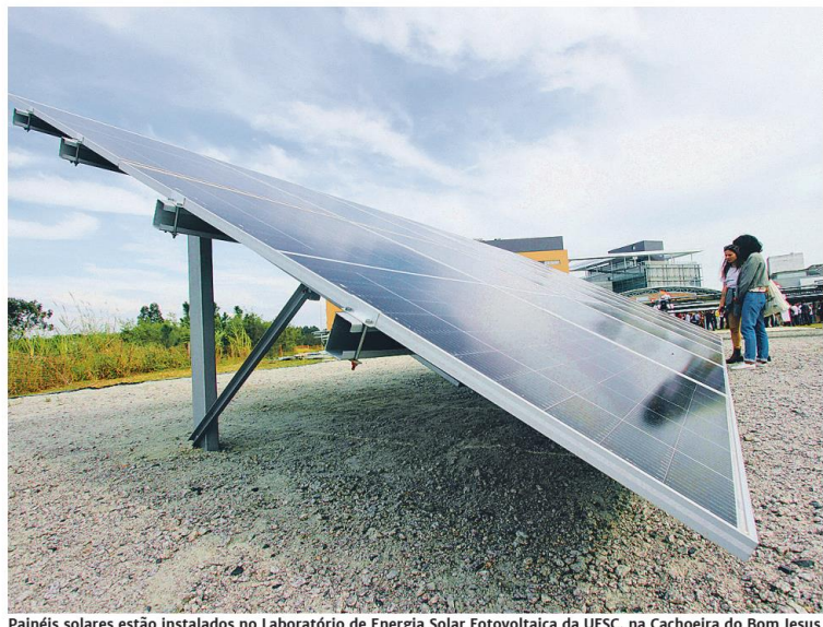
Painéis solares estão instalados no Laboratório de Energia Solar Fotovoltaica da UFSC, na Cachoeira do Bom Jesus
